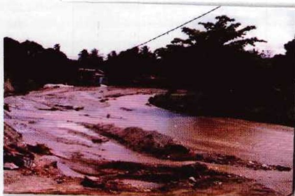
Foto 1a. Pelebaran pada alur sungai akibat banjir dan erosi
