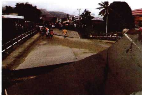
Foto 1b. Kerusakan jembatan akibat banjir dan erosi
